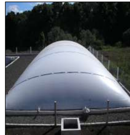
Uso de Biodigestores
